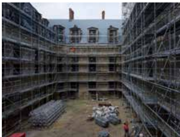
Château de Villers-Cotterêts, échafaudages sur la cour du Jeu de paume © Pierre-Olivier Deschamps / Agence Vu - CMN
