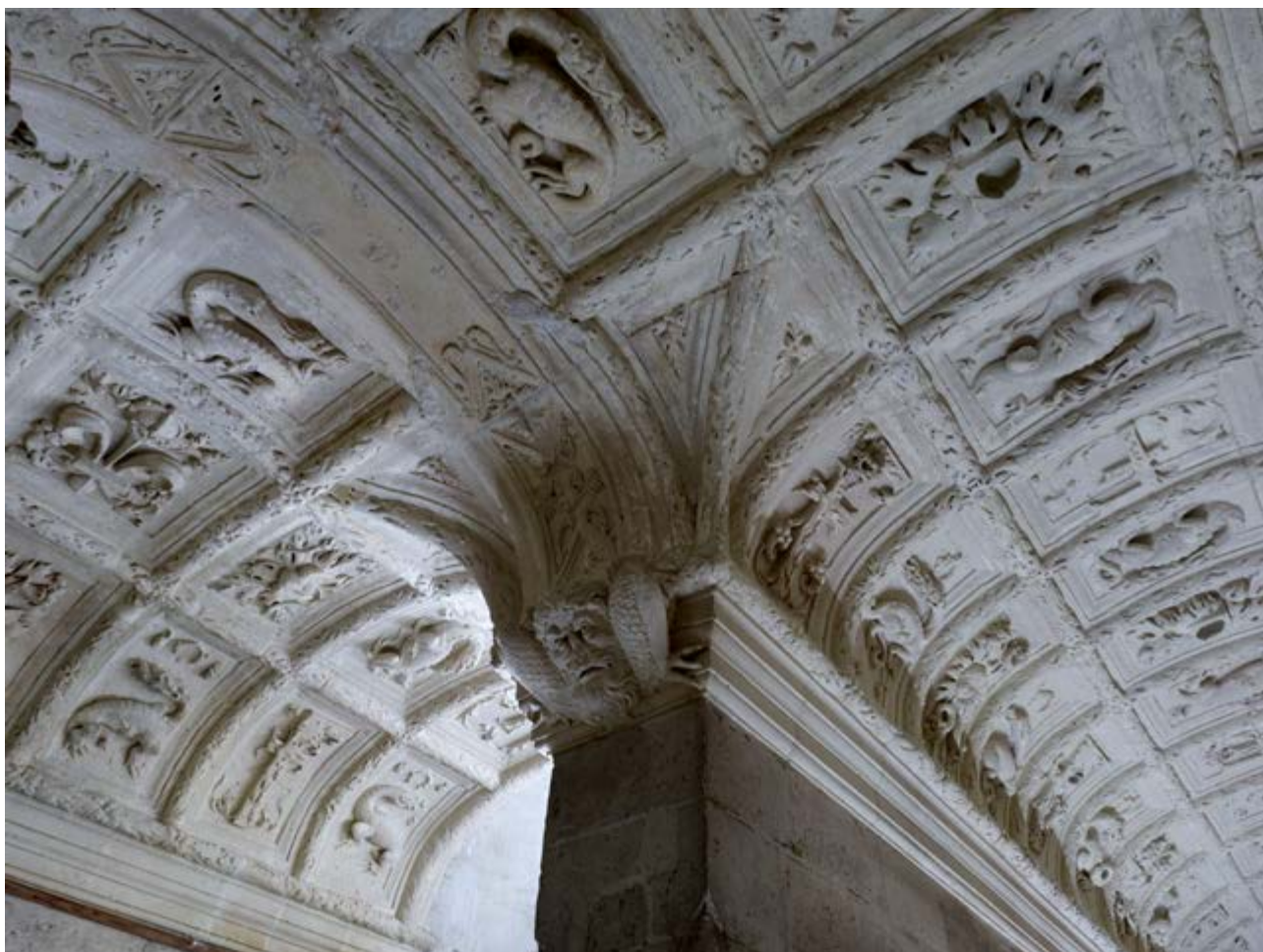
Logis royal, plafond à caissons de l'escalier du Roi restauré © Pierre-Olivier Deschamps / Agence Vu' - CMN
